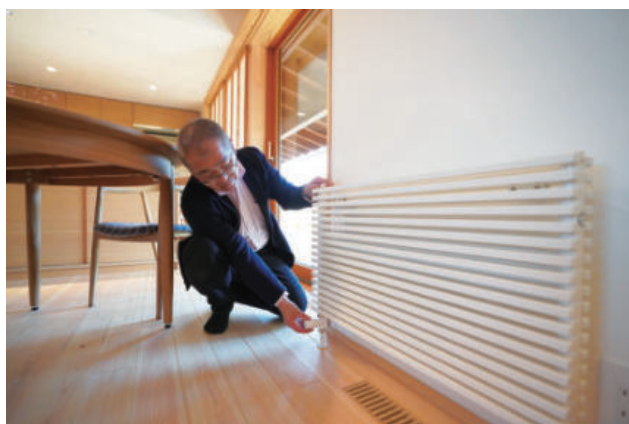
室内4カ所に設置した温水パネル。身体を芯からぽかぽかと温めます。
